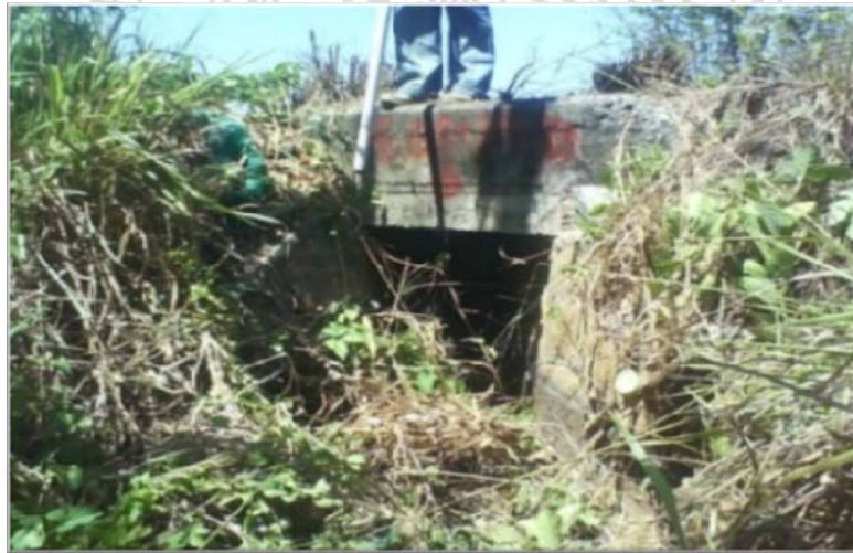
FOTOGRAFÍA 3.- Losa de concreto obstruida con ramazón denso
