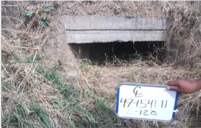
FOTOGRAFÍA 2.- Losa de concreto de 1m de altura, obstruida por vegetación
