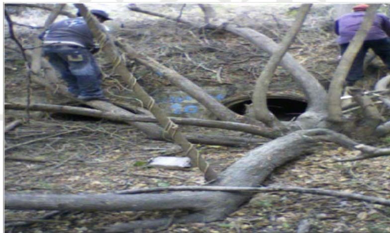
FOTOGRAFÍA 4.- Alcantarilla tubular de concreto de 0,90 m de diámetro, obstruida a la entrada con troncos
