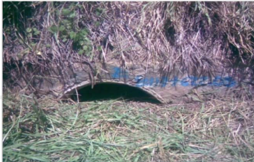
FOTOGRAFÍA 1.- Obra de drenaje menor, consistente en un tubo de concreto de 0,90 m de diámetro, azolvado en un 85%
